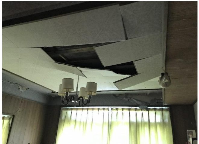
1階洋室（一部天井が落下）
