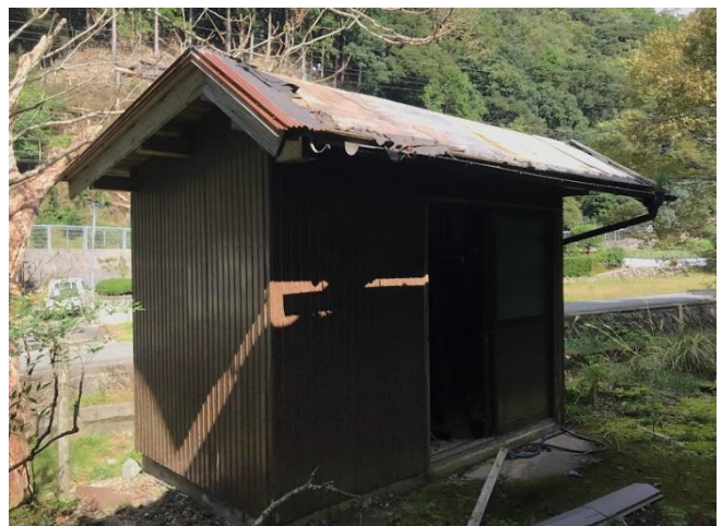
外物置（屋根に破損が見られる）
