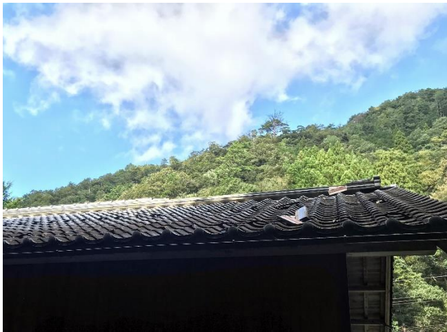
屋根（棟部に破損が見られ、瓦が落ちている）
